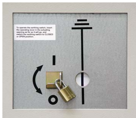
Рис. 107: Заземляющий нож шин находится в положении ВКЛЮЧЕНО ("CLOSED") и закрыт на навесной замок, версия с ручным управлением
