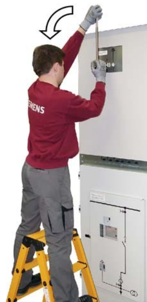
Рис. 112: Отключение заземляющего ножа шины, используя лестницу электрика
