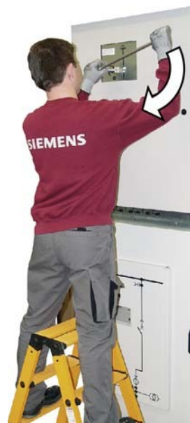
Рис. 99: Включение заземляющего ножа шин, применяя монтажную лестницу
