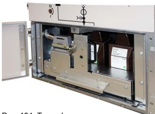
Рис. 134: Трансформатор напряжения в отсеке трансформатора напряжения.
