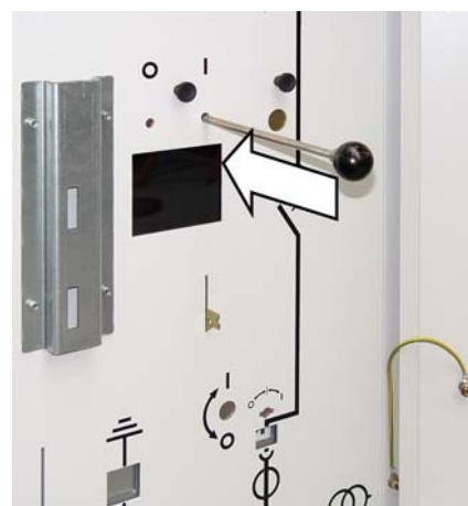
Рис. 62: На ячейке с моторным приводом; Дверца панели контроля закрыта
