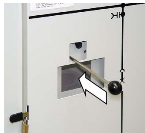
Рис. 69: На ячейке с моторным приводом; Дверца панели контроля закрыта
