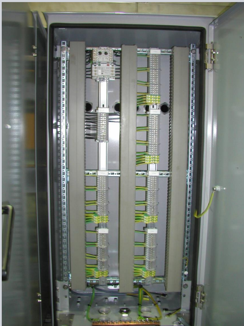
Соединение с трансформатором тока
